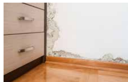
Likvidace škod po poškození vodou
